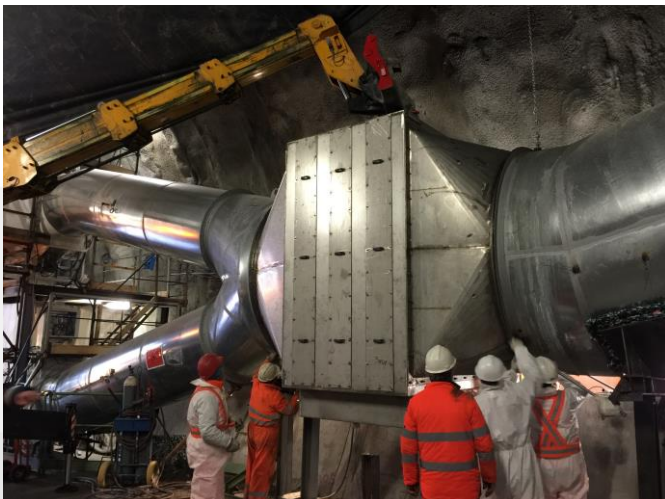
Sistema di rimozione gocce per un impianto di aspirazione aria all'interno di una galleria
